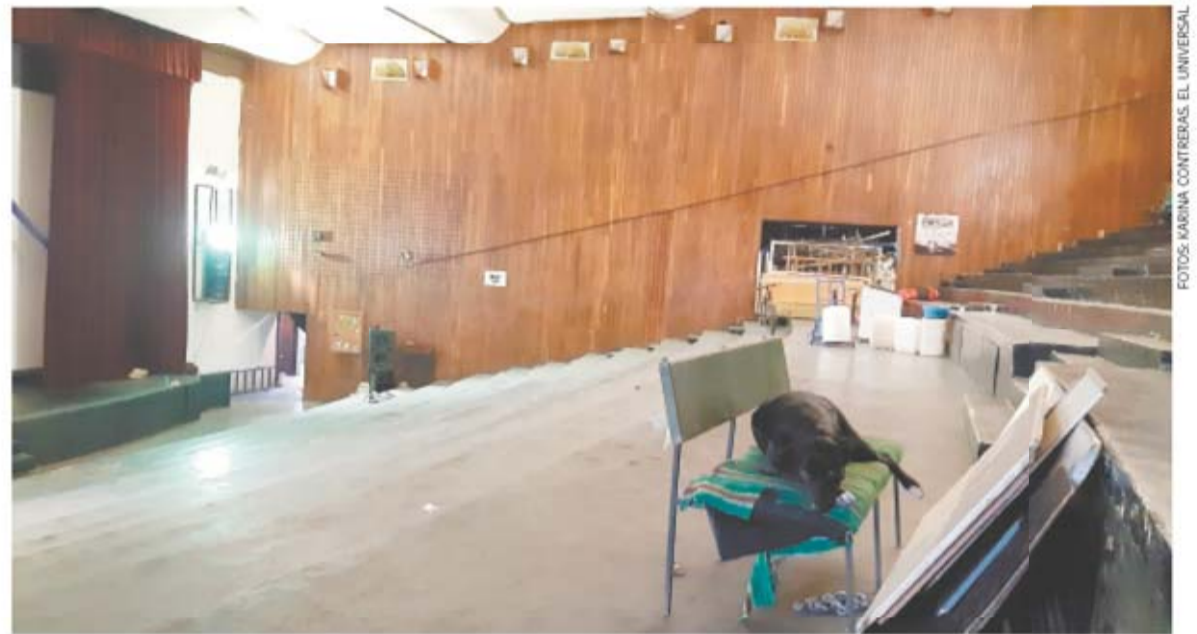
La sala de conciertos luce despojada hasta de sus butacas. Conserva las paredes recubiertas de madera y la acústica de su techo cóncavo, fracturado luego de los sismos de 2017.
