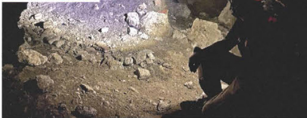
El socavón y parte de los daños que la humedad ha provocado en la Ciudad del Bienestar, proyecto insignia de Claudia Sheinbaum en la CDMX.
