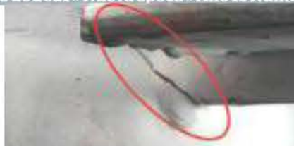
UNA de las fisuras recién detectadas.
