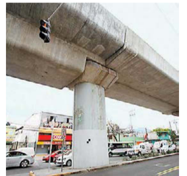
Obra defectuosa. ESPECIAL
