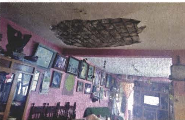
Vecinos reportan grietas y desprendimientos en sus casas.
