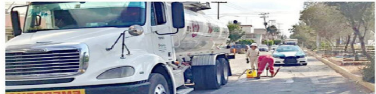
■ Cuadrillas de Pemex y de SGIRPC limpiaron colectores de desagüe en la zona.
