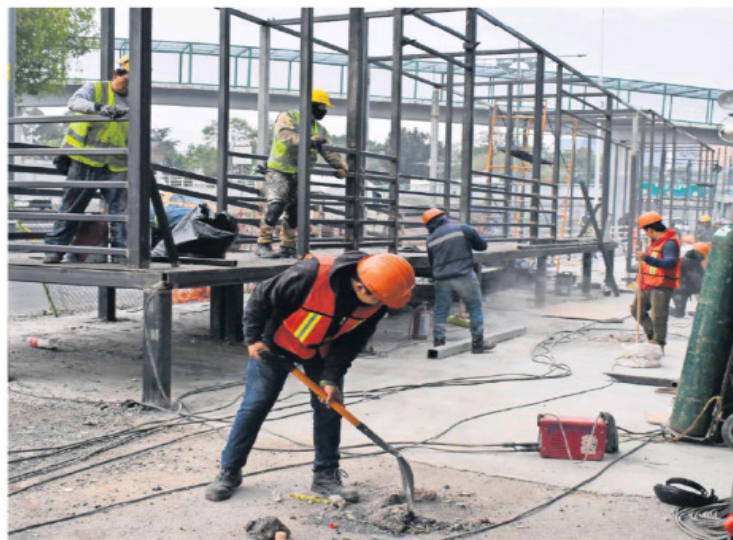
Trabajadores de la Secretaría de Movilidad están a marchas forzadas para concluir las paradas del Metrobús que prestará servicio alterno por el cierre, a partir de mañana, del tramo Pantitlán a Velódromo de la Línea 9 del Metro. | METRÓPOLI | A16
