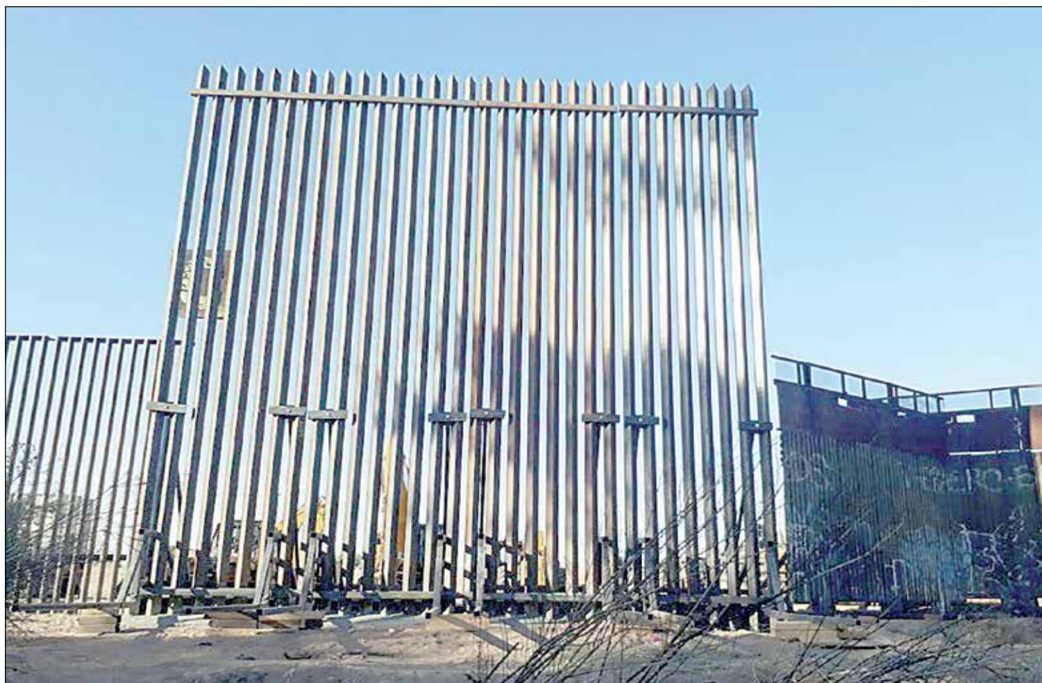
El 19 de febrero dio inicio la construcción del primer tramo de una barrera de polines de hierro, que se edificará a lo largo de 3.2 kilómetros en la frontera entre Calexico y Mexicali. El presidente Donald Trump ha expresado en sus planes que quiere "un muro grande y hermoso" ■ Foto Antonio Heras
