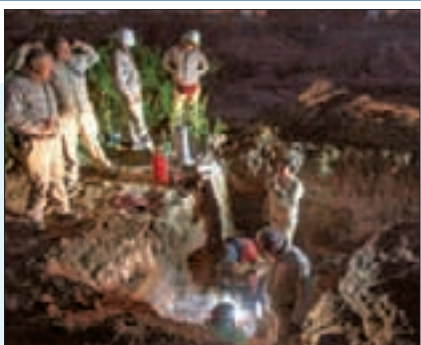
Cuadrillas de Pemex y de Sedena reparan ductos perforados cerca de Tula.
