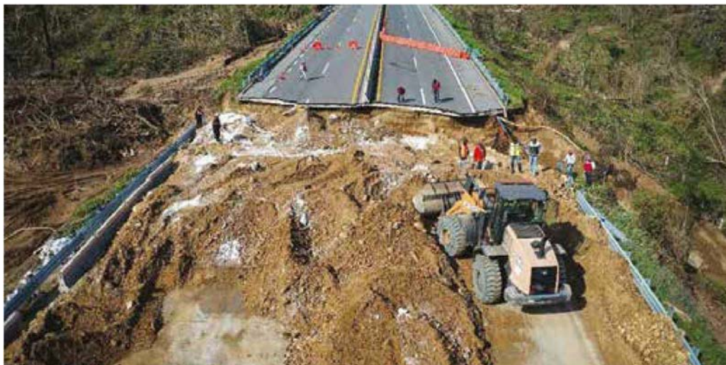
Muy dañado, el libramiento carretero de Pie de la Cuesta. (Foto: Cuartoscuro)
