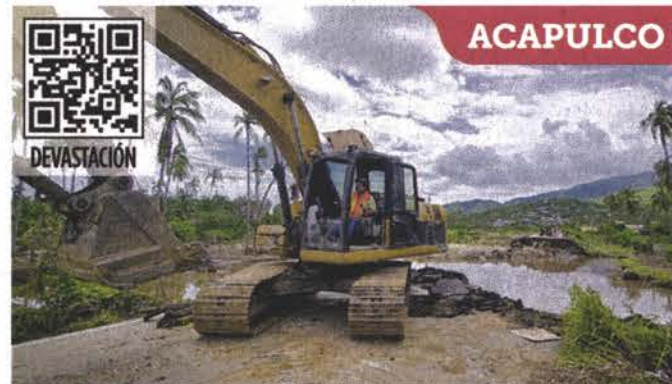
La carretera que comunica a Coyuca de Benítez con la Costa Grande, se encuentra dañada.
