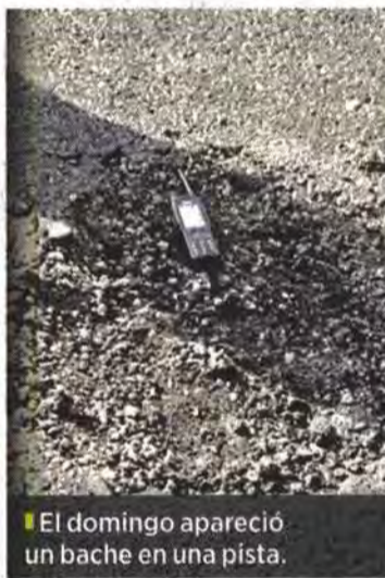
En 2020, las pistas del aeropuerto tuvieron obras y mantenimiento mayor. Ahora, la rehabilitación regresa al AICM.
