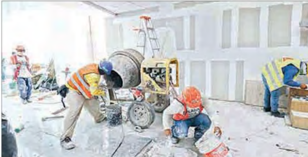
▲ Trabajos de mantenimiento en la Terminal 2 en julio de 2020. Ante el deterioro de las instalaciones, el gobierno analiza apuntalar el edificio. Foto Luis Castillo
