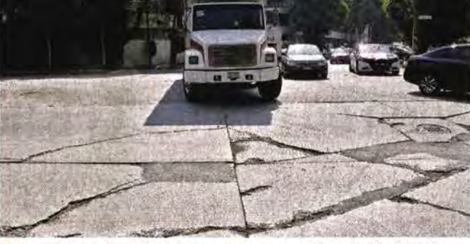
Las grietas y hundimientos regresaron a la Avenida Ceylán.
