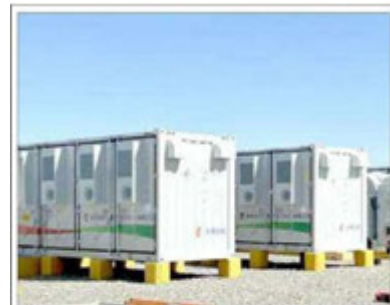
Ingeniero Juan Antonio Fernández , la Central Fotovoltaica de Puerto Peñasco que incluye una superficie de 2 mil hectáreas y una capacidad de generación de 1 GW
