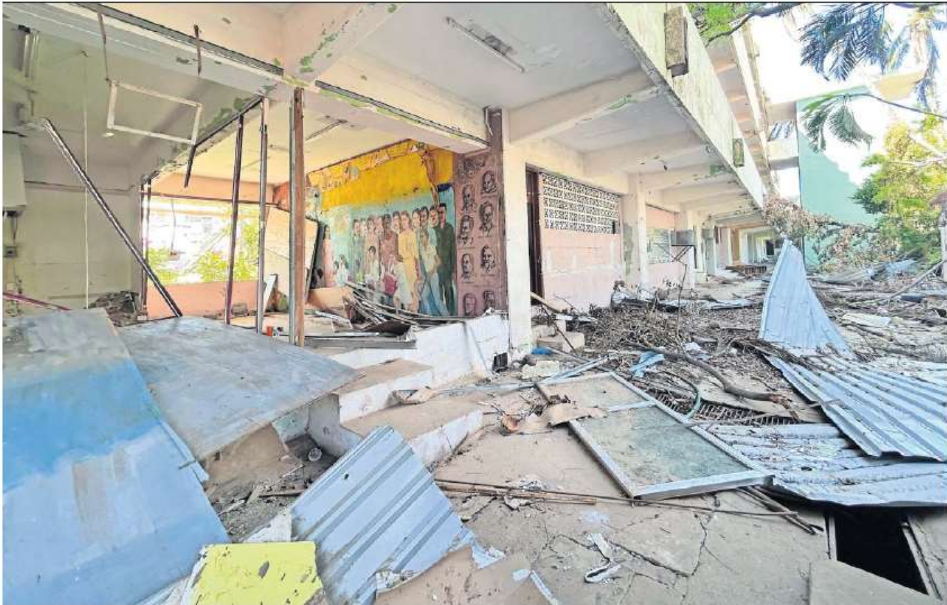
Escuelas como la Federal 1, en Acapulco, resultaron severamente dañadas por el huracán del 25 de octubre. Aún permanecen los escombros en las aulas y no hay todavía plan de restauración ni fecha de regreso a clases.
