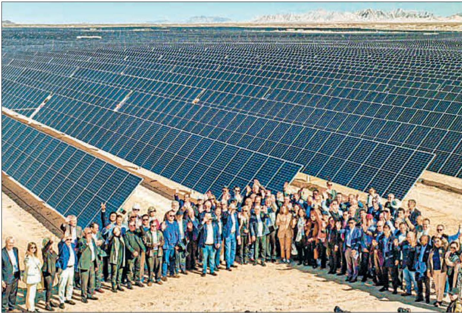
▲ Vista de la planta fotovoltaica en Puerto Peñasco, Sonora, la cual está conformada por miles de paneles solares instalados por la Comisión Federal de Electricidad. El canciller Marcelo Ebrard encabezó la visita al lugar en compañía de 80 embajadores y 25
