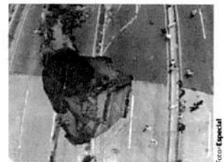
LA PROFUNDIDAD del socavón es de cinco metros.
