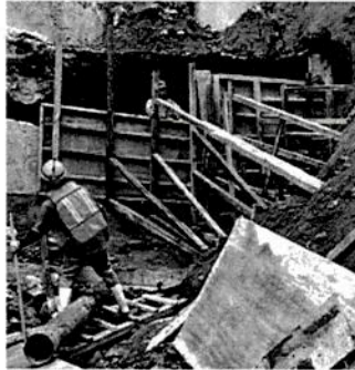
La reparación, un día antes de la tragedia, fue insuficiente.
