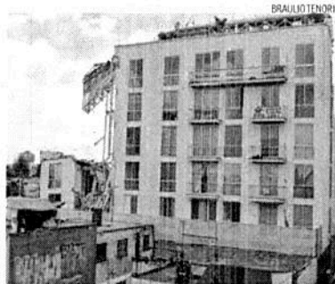
PORTALES. Tiene un año y graves problemas estructurales.
