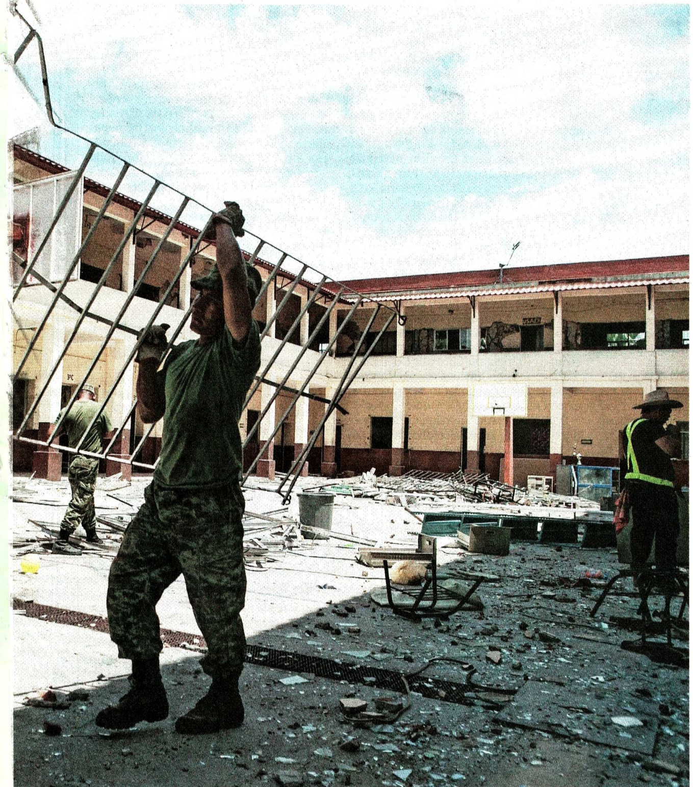
Las labores de reconstrucción en los municipios afectados por el movimiento telúrico han comenzado. En las escuelas se ha priorizado la rehabilitación de los inmuebles para que los niños no dejen de asistir a clases.
