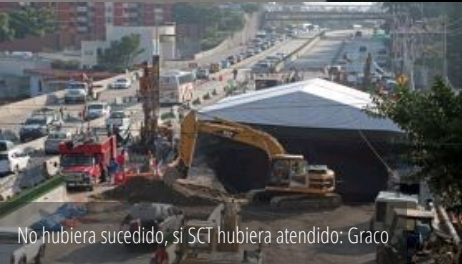
Ingenieros recomiendan demoler zona del socavón
