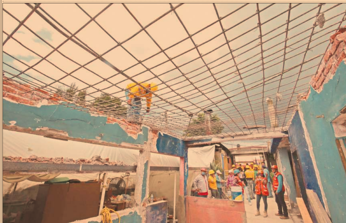
Las labores de rescate en varios inmuebles de la CDMX terminaron y ya ni cascajo hay, mientras en otras zonas el trabajo continúa y esperan ayuda de la autoridad. FOTO EE: HUGO SALAZAR P38-39
