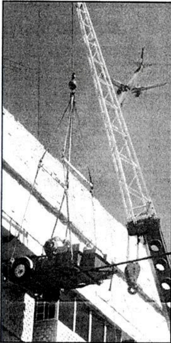
Vecinos del edificio dañado en Xola y Navarra logran resquepar algunos de sus pertenencias con la ayuda de una grúa que les proporcionó el gobierno capitalino.
