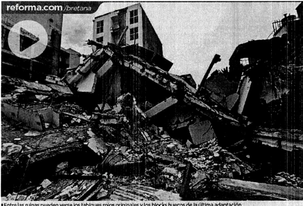
Entre las ruinas pueden verse los tabiques rojos originales y los blocks huecos de la última adaptación.
