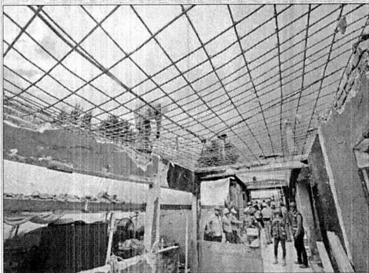
Las labores de rescate en varios inmuebles de la CDMX terminaron y ya ni cascajo hay, mientras en otras zonas el trabajo continúa y esperan ayuda de la autoridad. FOTO EE: HUGO SALAZAR P38-39
