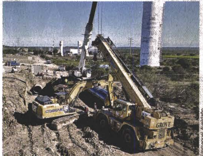
DUCTO SIN UNIR. Zanjas y tubería sin unir se capturaron sobre el trayecto del acueducto a la altura de la Planta de Bombeo No. 2, en Los Ramones.
