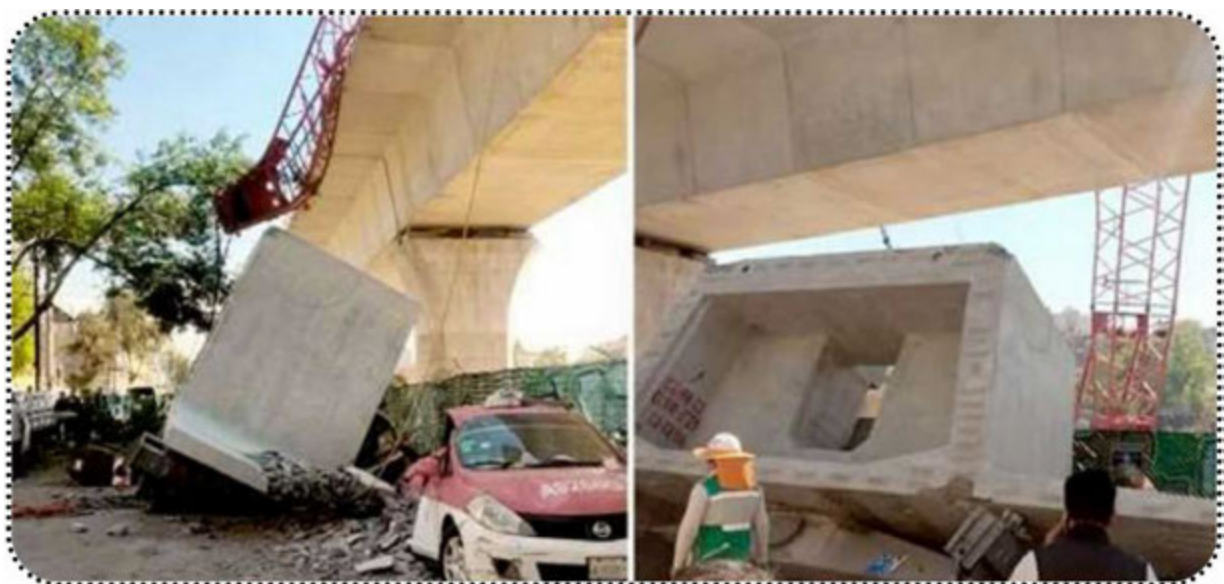
Desplome de bloque de concreto en tramo donde se construye Tren Interurbano
