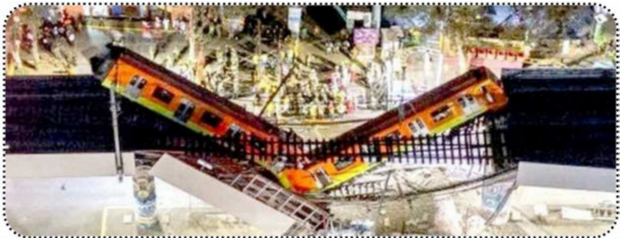
Tramo colapsado estructura de la Línea 12 del Metro entre estaciones Olivos y Tezonco
