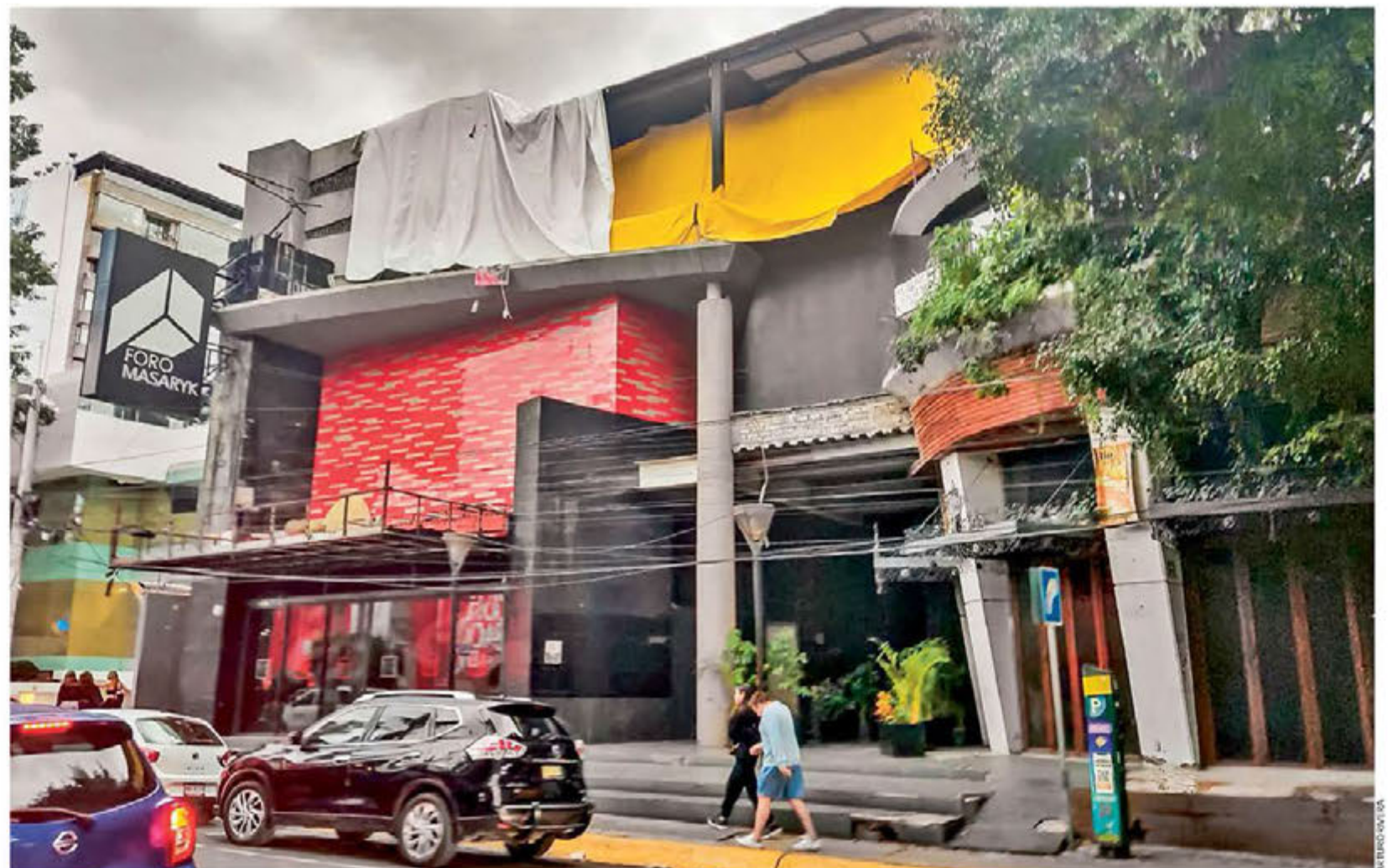
OBRAS IRREGULARES. Edificaciones de antros ilegales, con el aval de la alcaldía Miguel Hidalgo, se suman a los problemas de inseguridad que viven y denuncian colonos de Polanco, quienes añaden que los permisos de uso de suelo anómalos incentivan la proliferación de esos giros CDMX P. 7
