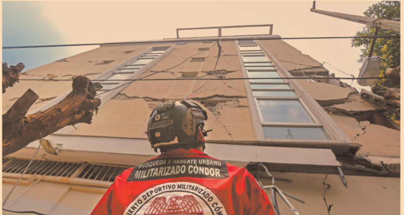
Estructuras. Edificios, sobre todo en Oaxaca y la capital del país, se dañaron y algunos fueron desalojados. FOTO EE: ERIC IUGO
