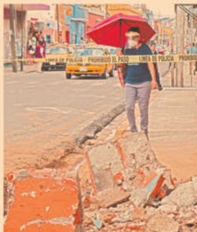
Bloques. En Oaxaca, algunos muros cayeron sobre las aceras. FOTO: REUTERS
