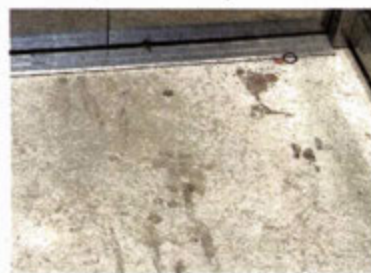
Piso del elevador sin lavar.
