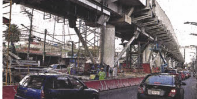
Las obras del tramo Zapotitlán-Nopalera fallaron.
