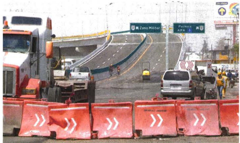
Alrededor del aeropuerto continuaban ayer dando los últimos retoques a las obras.
