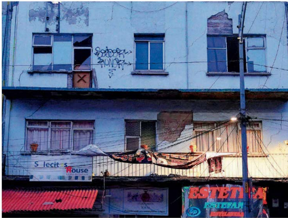
DIVERSOS inmuebles de la ciudad, particularmente en la zona poniente, han registrado daños con los microsismos, como el registrado el pasado 14 de diciembre.
