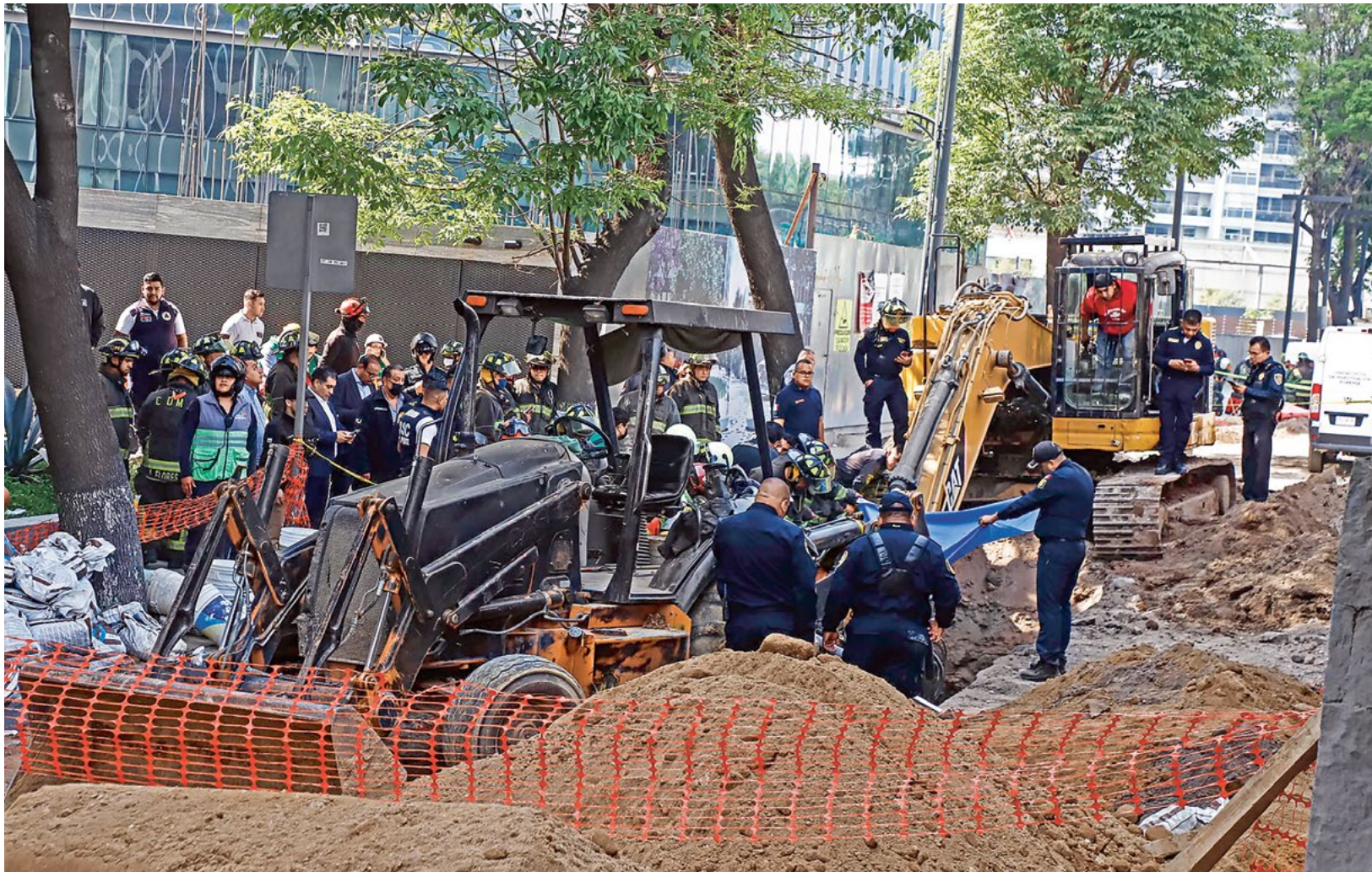
TRAGEDIA. Muere un trabajador y otro resulta herido al quedar sepultados durante el derrumbe de una obra del Sacmex en la alcaldía Miguel Hidalgo, cuando realizaban cambios a la tubería del drenaje en Río San Joaquín CDMX P.7
