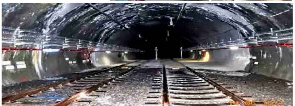
Entre los cadenamientos 29+260 al 29+280 se presentan graves problemas de filtraciones, escurrimientos y goteo de agua en la bóveda y paredes del túnel.
