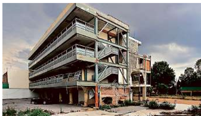
A tres años del sismo, así luce el inmueble del Colegio Rébsamen, ubicado en la Alcaldía Tlalpan.
