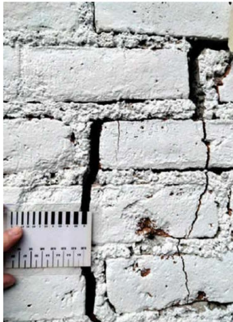
GRIETA reflejada en estructura después del sismo del 14 de diciembre del 2023.
