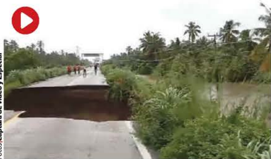
COLAPSO de la carretera Acapulco-Zihuatanejo, ayer.
