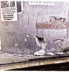
Ayer circularon imágenes de los daños en los pilares del Metro, tras los sismos del 2017.
