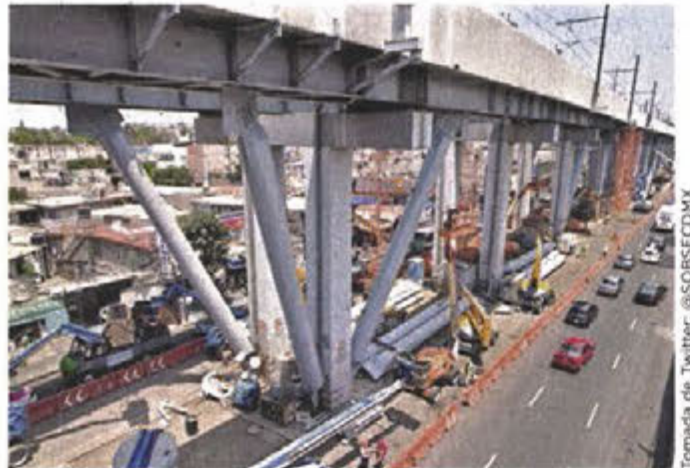
Una trabe del tramo elevado de la Línea 12 del Metro se desplomó el 3 de mayo de 2021.
