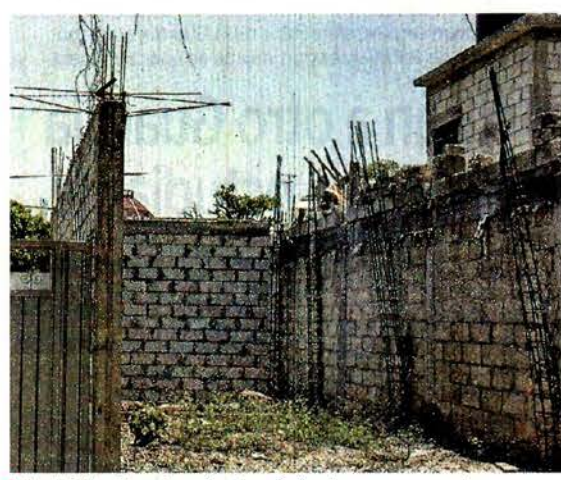
En Jojutla, Morelos, aún hay viviendas que se quedaron a la espera de apoyos tras el sismo de 7.1 grados el 19S de 2017.
